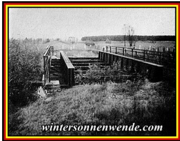
Deutsche Ostnot: Zerstörte Eisenbahnbrücke bei Unruhstadt-Wollstein. Photo Scherl.
