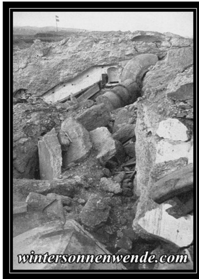
Die verheerende Wirkung eines einzigen deutschen 42-cm-Geschosses auf einen Panzerturm des Fort Loncin in der Festung Lüttich am 7. August 1914. Unter den Trümmern dieses Forts liegt ein Teil der belgischen Besatzung begraben.
