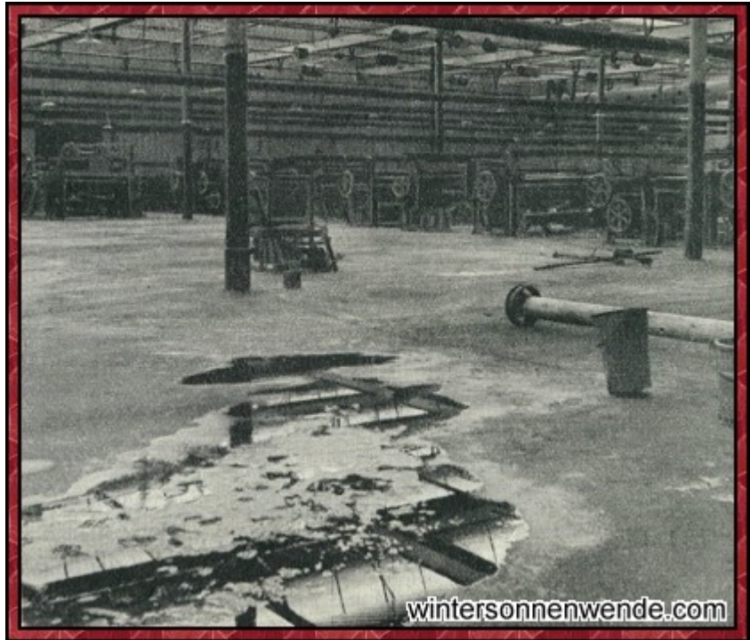
Das Regenwasser fällt durch das morsche Dach. Die Stätte froher Arbeit und jahrzehntelangen Unternehmerfleißes ist ein Abbruchhaufen geworden. Systematisch fördert die unfähige Staatsverwaltung den Verfall einer im alten Österreich blühenden Wirtschaft, richtet dreieinhalb Millionen Menschen, die nie den tschechischen Staat gewollt hatten, zugrunde.
